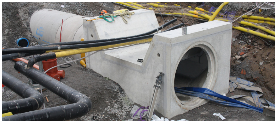
Lågbyggt rörelement vid ledningskorsning, DN 1400
