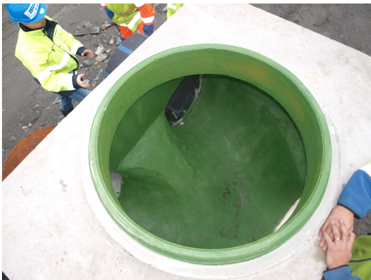
Bild: RV 155 Göteborg, inloppsbrunn ALFA SVR Elementbrunn
